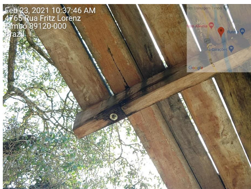
Figura 19 - Sistema de fixação das transversinas de madeira - chapas metálicas em estado avançado de oxidação
