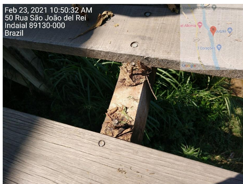
Figura 13 – Transversina intermediária sob a tábua faltante do tabuleiro de madeira
