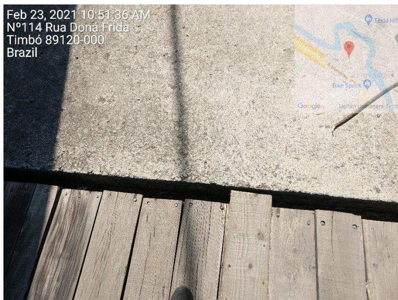
Figura 3 – Cabeceira margem esquerda – tábua desalinhada em relação ao tabuleiro de madeira
