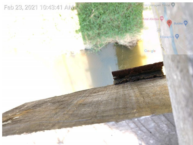
Figura 81 - Sistema de fixação das transversinas de madeira - chapas metálicas em estado avançado de oxidação
