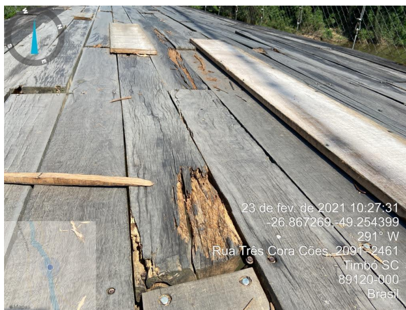
Figura 9 - Tábuas de madeiras soltas e em avançado estado de degradação
