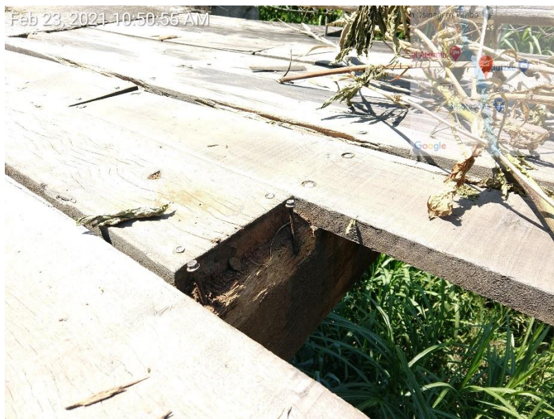
Figura 64 – Transversina da tábua faltante do tabuleiro de madeira - degradação da área superior da peça
