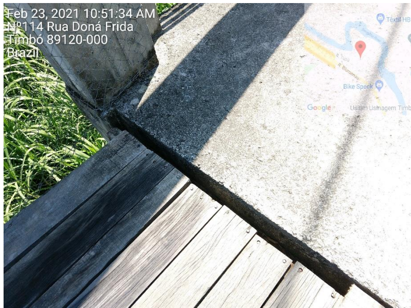
Figura 2 - Cabeceira margem esquerda – encontro entre estruturas de concreto e madeira
