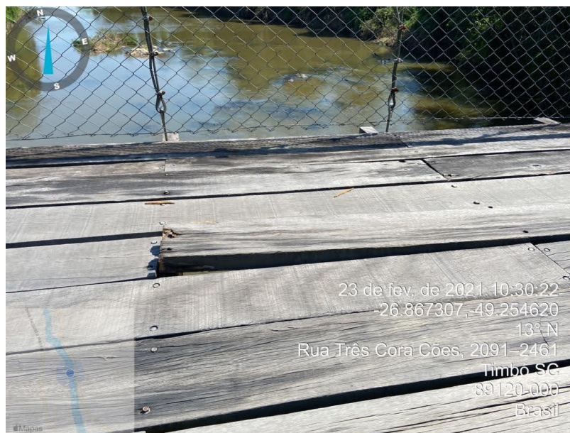
Figura 41 - Tábuas de madeiras soltas e em avançado estado de degradação
