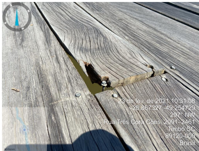
Figura 30 - Tábuas de madeiras soltas e em avançado estado de degradação
