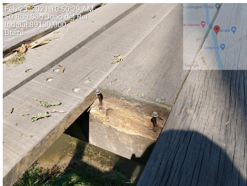
Figura 52 – Transversina da tábua faltante do tabuleiro de madeira - degradação da área superior da peça
