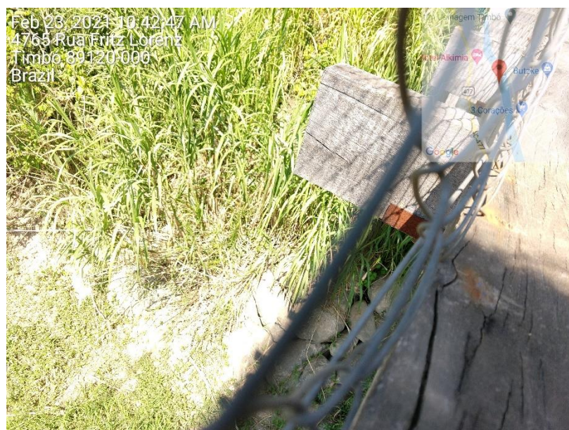
Figura 20 - Sistema de fixação das transversinas de madeira - chapas metálicas em estado avançado de oxidação
