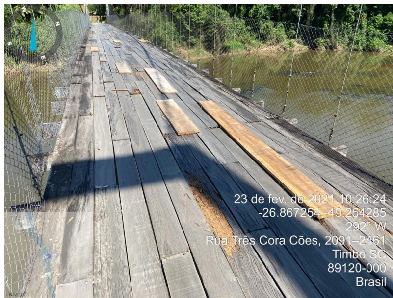
Figura 6 - Tabuleiro de madeira danificado
