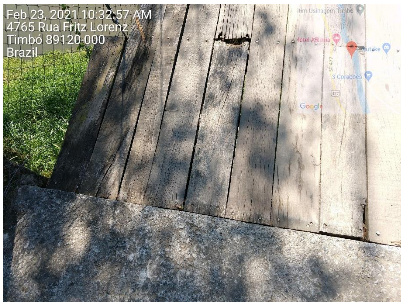
Figura 16 - Cabeceira margem direita - desgaste do tabuleiro devido ao atrito com estrutura de concreto
