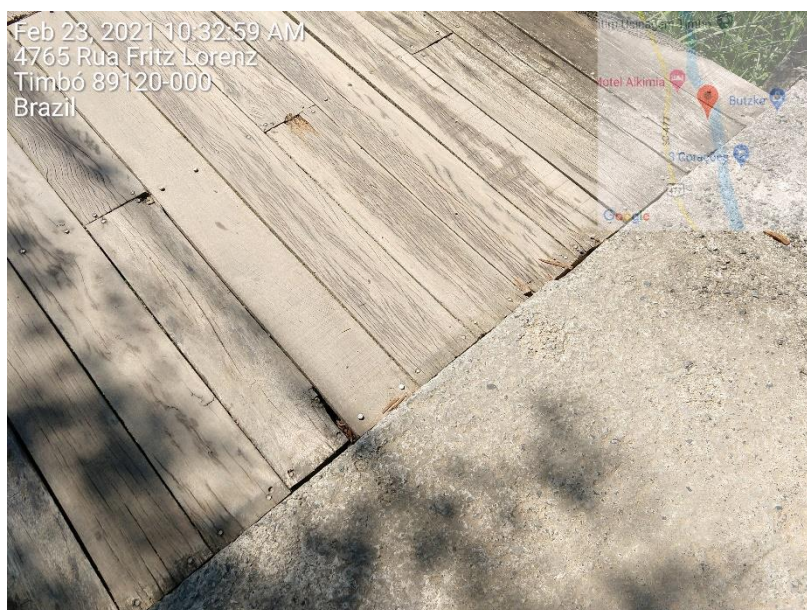
Figura 17 - Cabeceira margem direita - desgaste do tabuleiro devido ao atrito com estrutura de concreto
