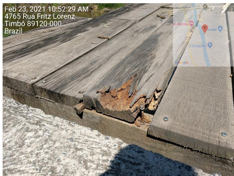
Figura 75 – Tábuas de madeiras soltas e em avançado estado de degradação
