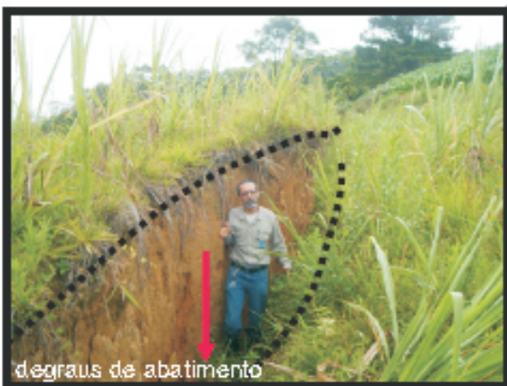
subdimensionamento das drenagens
